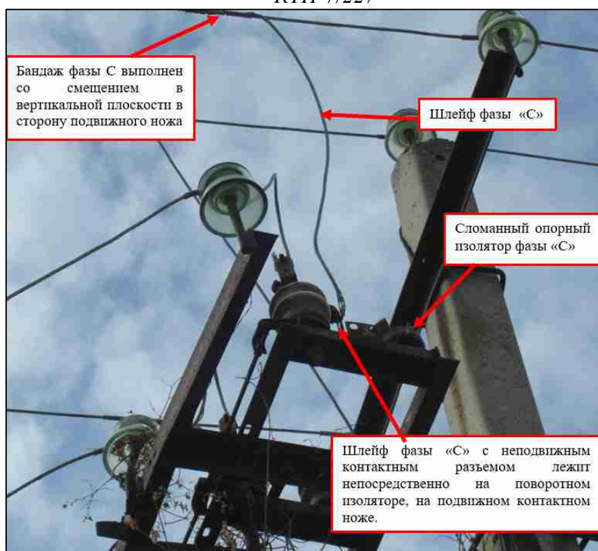
Опора № 3/11 воздушной линии электропередачи 10 кВ Ф-227
