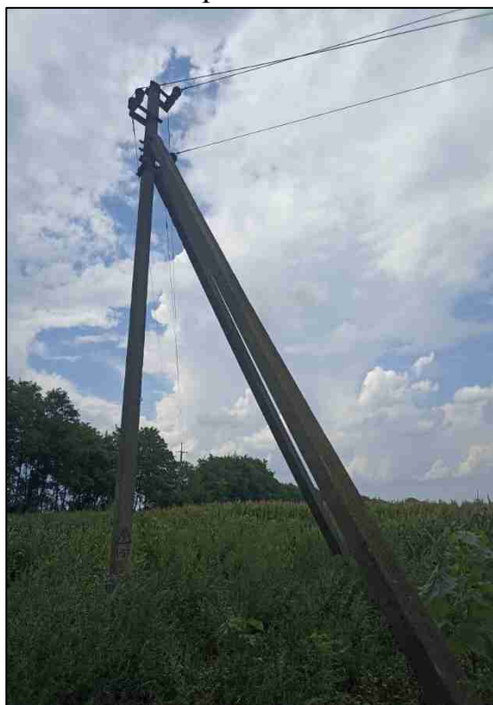
Опора № 1/57 ВЛ-10 кВ БП-3
